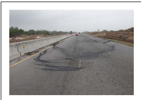
Fotografía N° 7 Corrimiento de la carpeta de concreto asfáltico por lisura extrema de la superficie de la base.
