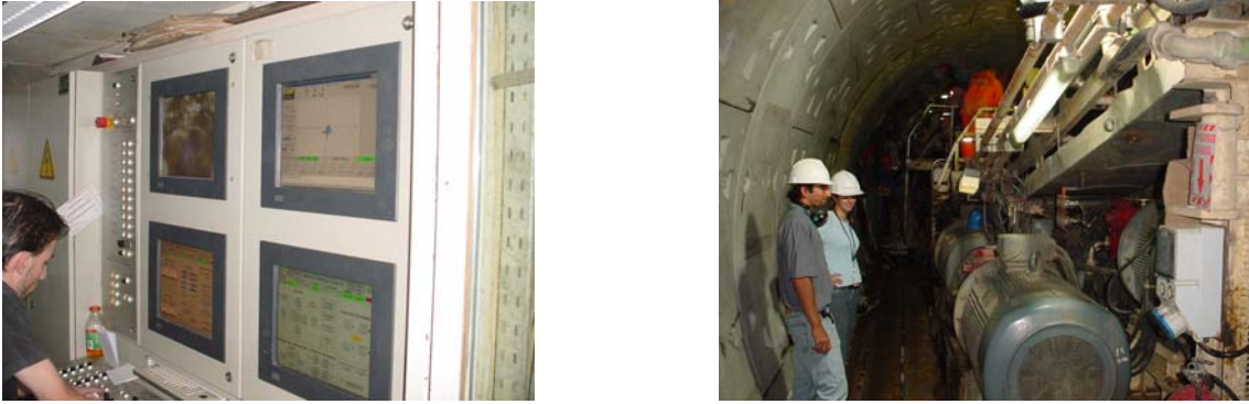
Fotos 3 y 4 Sala de control interna ubicada dentro de los TBM-EPBs Norte y Sur. Ubicada bajo tierra. Diseñada para el control de las presiones de excavación e Inyección del Grout.
